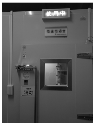
写真5 恒温恒湿室の中に検査用の医薬品が多数保管されていました
