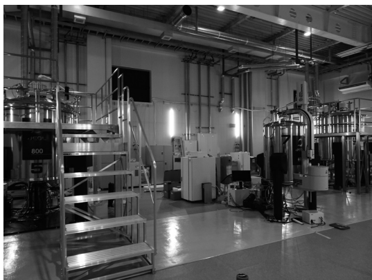
写真9 NMR棟に設置されているNMR装置
