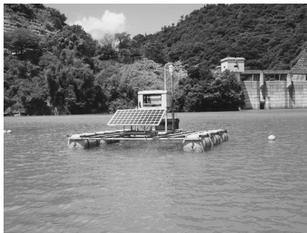
図2 水質計自動昇降装置設置状況
